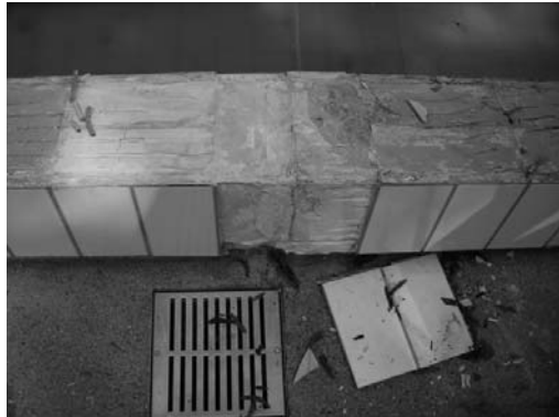
Hier muss noch Hand angelegt werden!
